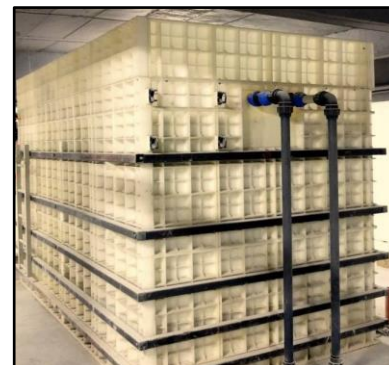
Sistema Júpiter instalado en un Hotel
